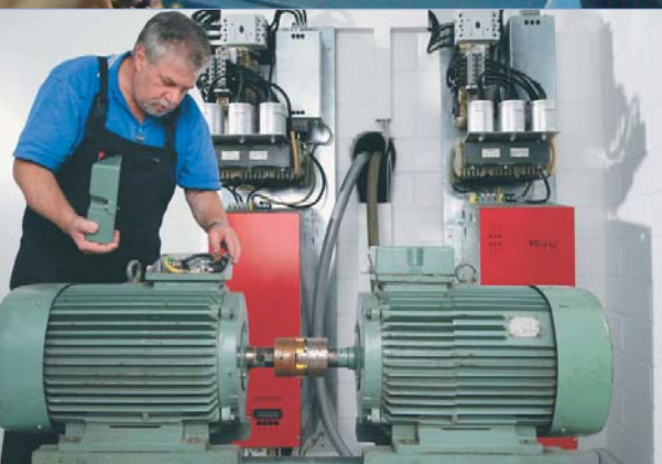
De belasting van de frequentieregelaar wordt aangesloten om vervolgens de elektromagnetische effecten ervan te kunnen meten.
